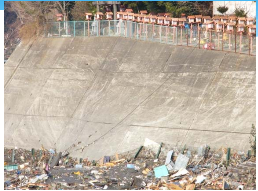
写真2 神社の擁壁 瓦礫がこすった傷が残っている
