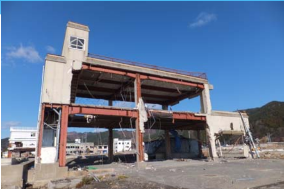
消防団被害写真4 被災当時のままの大槌町消防会館 (消防団本部・第一分団第三部屯所併設)
